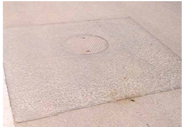
⬆ Javított aszfalt – a javítás nyoma megmarad, ami új hiba forrása
